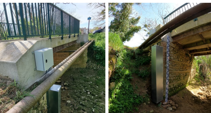
Mise en place du système d'alerte sur le pont de la Taillade au Vernet, 04 avril 2024 (Photo ©Aquifères)
